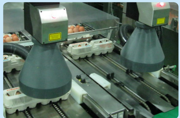
Lasery zainstalowane na linii pakującej
