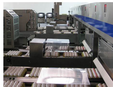
Imprimantes jet d'encre continu installées sur la calibreuse
