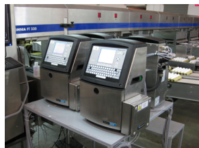
安装在分级机旁的喷码机
